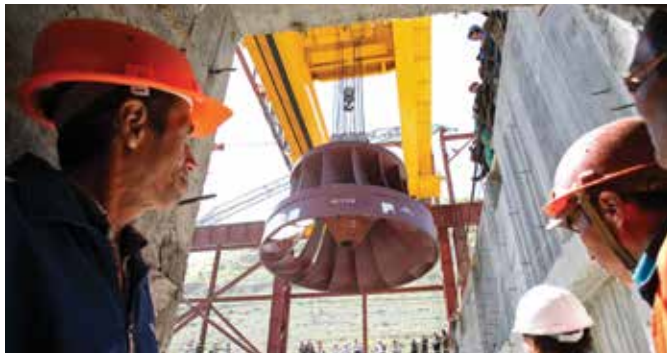
Кыргызские рабочие устанавливают турбину на гидроэлектростанции. Некоторые электростанции страны оборудуются дополнительными средствами защиты. РЕЙТЕР
